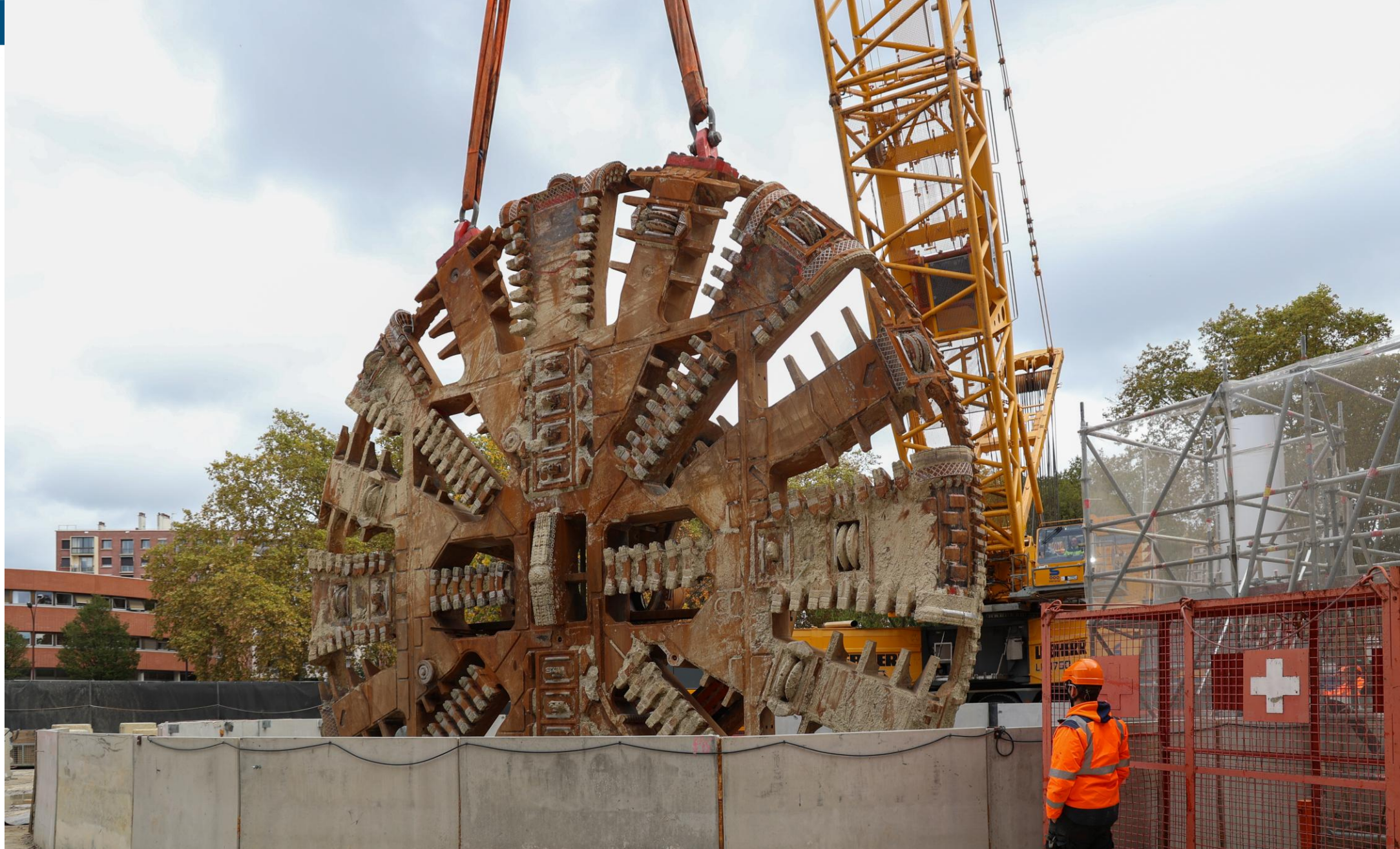
Démontage du tunnelier Marguerite de Catellan après son arrivée le 14 octobre 2025 au puits Saint Sauveur
